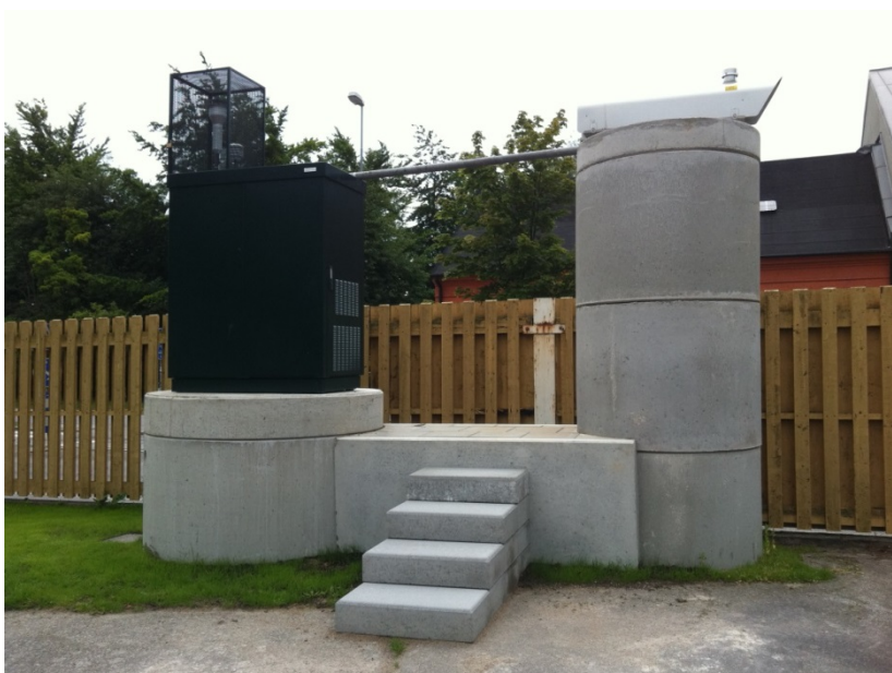
Den nya mätstationen vid Trollebergsvägen. Till vänster partikelmätaren (TEOM/FDMS) och till höger luftgasmätaren (DOAS).
